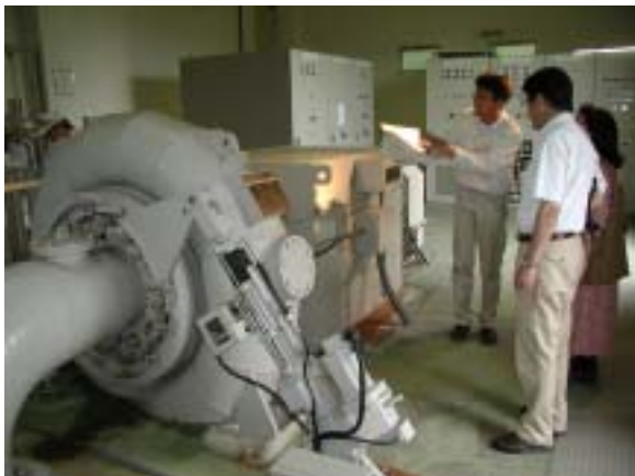
ます淵発電所 (小倉南区大字木下)
