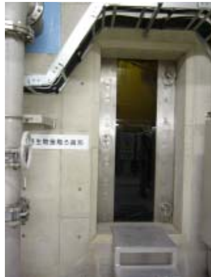
上向流式生物接触ろ過池（確認窓）
